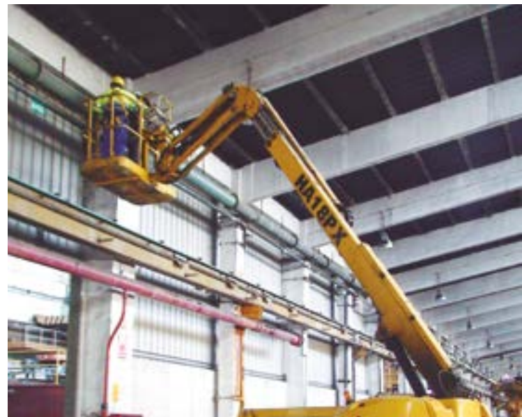
Fig 18. Elemento a reparar a unos 8 metros de altura
