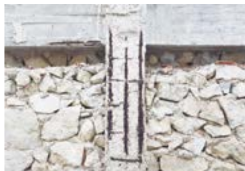
Fig 58. Pilar en sótano afectado por corrosión
