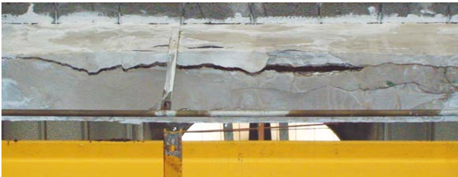
Fig 51. Detalle de grieta en cara inferior de viga de canto
