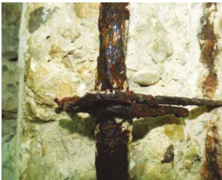
Fig 142. Restos de hormigón por picado insuficiente
