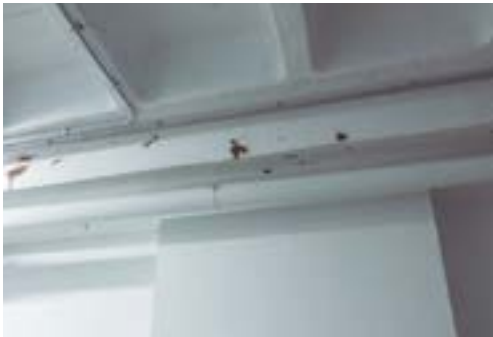
Fig 56. Ménsula vaso de piscina con manchas de óxido
