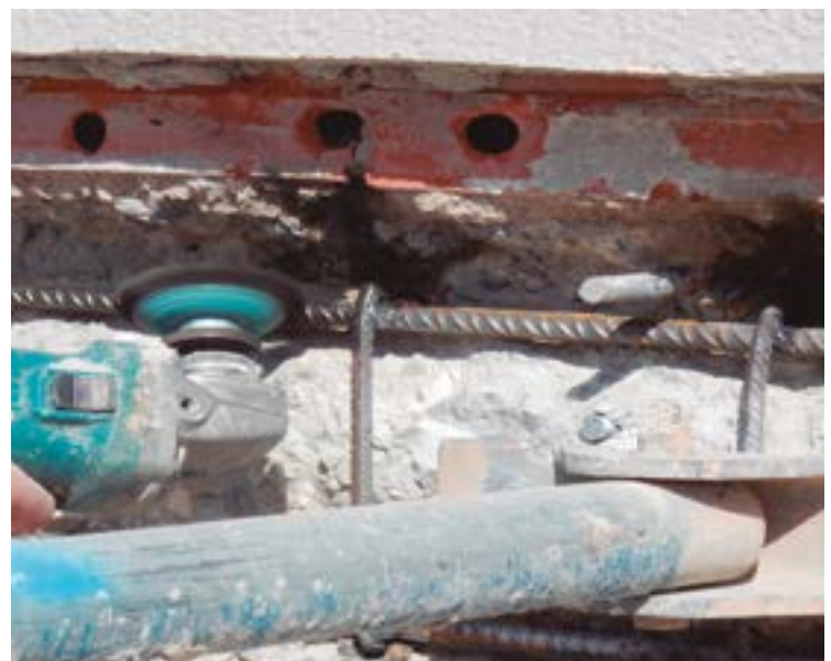
Fig 3. Fase de limpieza de restos de oxidación en barras
