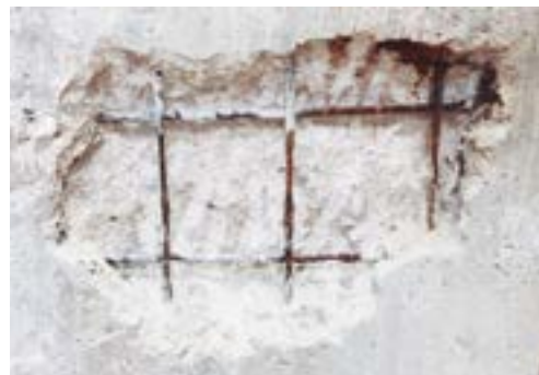
Fig 63. Cata en muro de sótano afectado por oxidación
