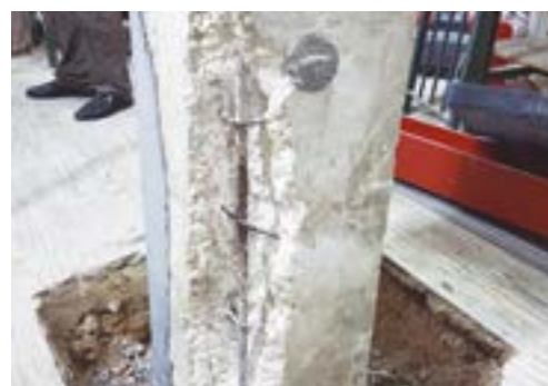
Fig 61. Corrosión puntual en pilar exento
