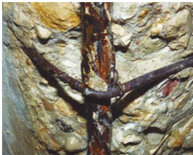
Fig 143. Restos de hormigón contaminado en encuentro de barras
