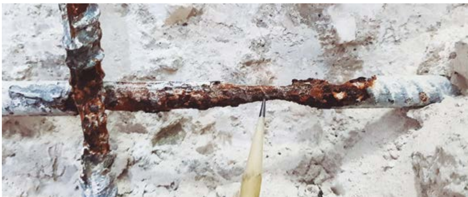
Fig 65. Detalle de picadura puntual en armadura de muro
