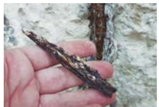
Fig 31. Resto de armadura totalmente corroída
