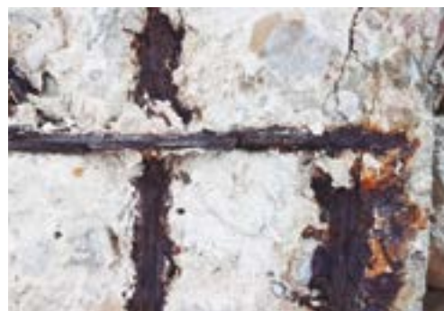
Fig 59. Detalle de corrosión en pilar
