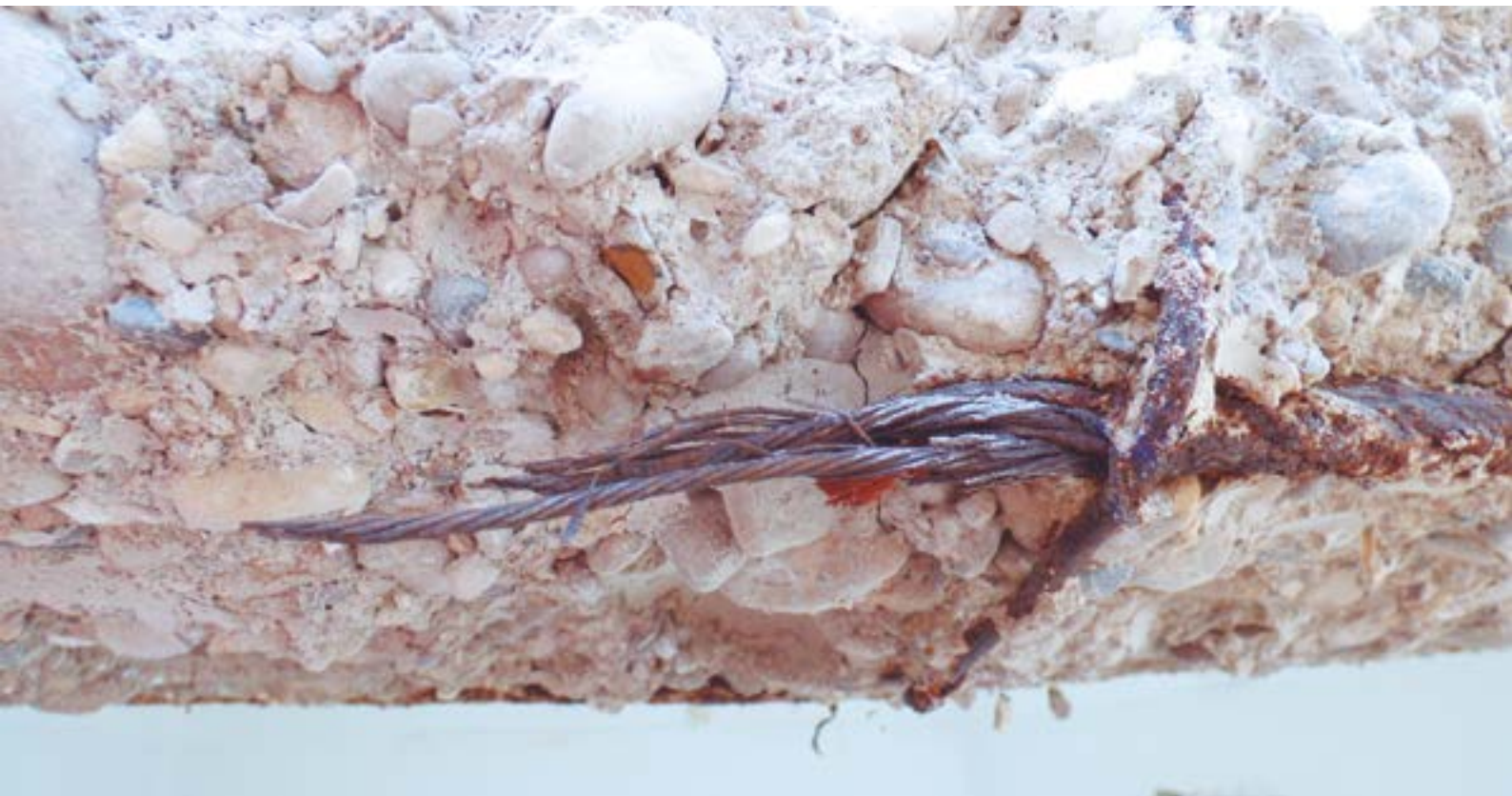
Fig 14. Corrosión en armado de alambre trenzado y hormigón de muy baja calidad
