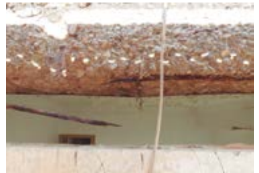
Fig 13. Afección generalizada en frente de vivienda
