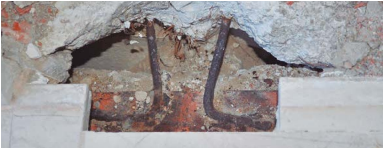
Fig 81. Detalle de cata en anclaje sin impermeabilización bajo pavimento modificado
