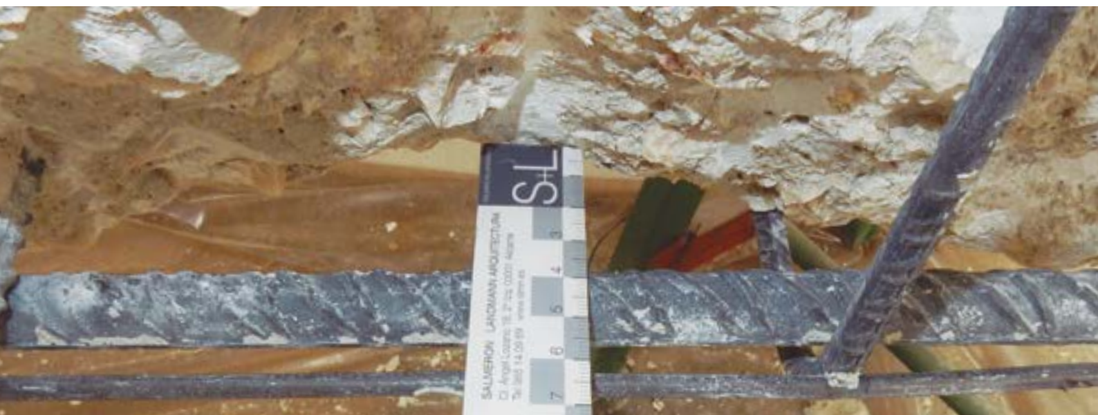
Fig 109. Detalle holgura picado del hormigón
