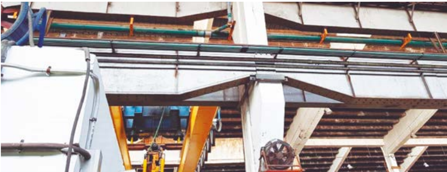
Fig 42. Corrosión en soportes de puente grúa
