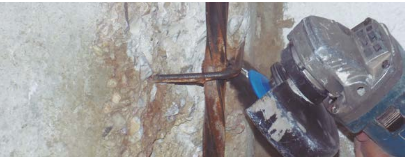
Fig 149. Ejemplo de la dificultad de llevar a cabo una limpieza completa adecuada
