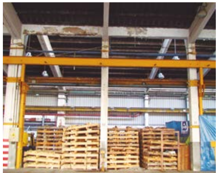
Fig 16. Zona afectada en edificio industrial con puente grúa
