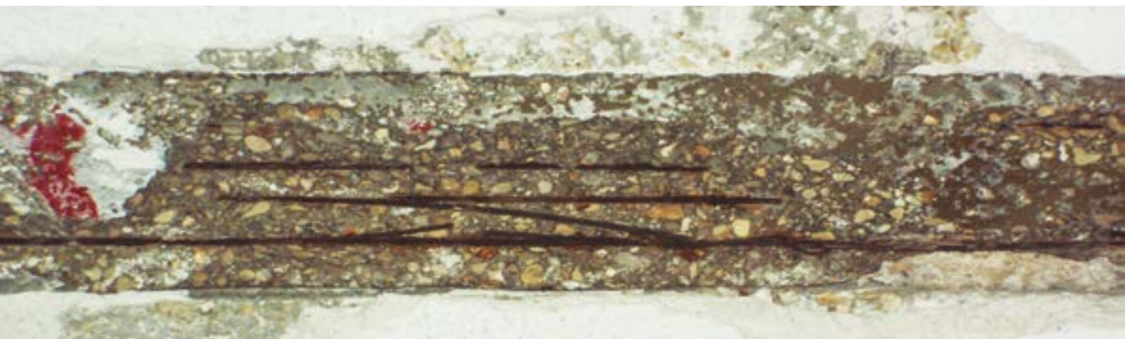
Fig 84. Detalle de vigueta con cemento aluminoso afectada por corrosión de armaduras
