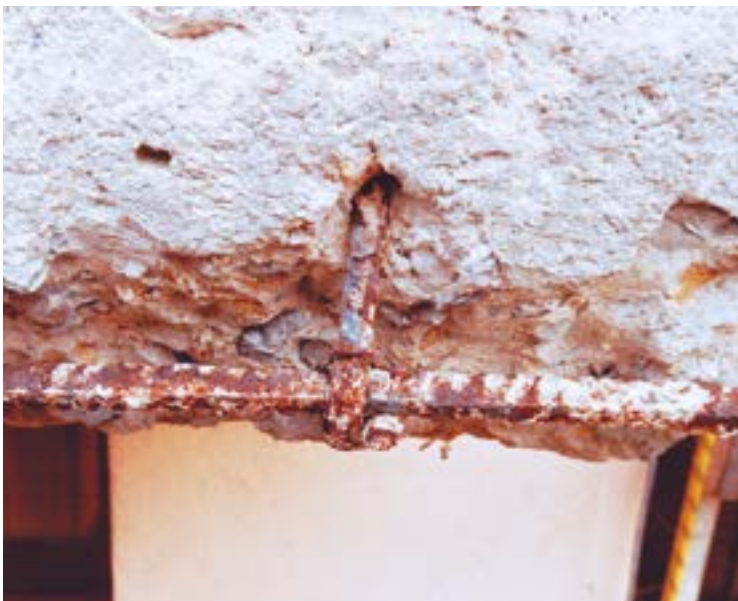
Fig 10. Grado de corrosión bajo
