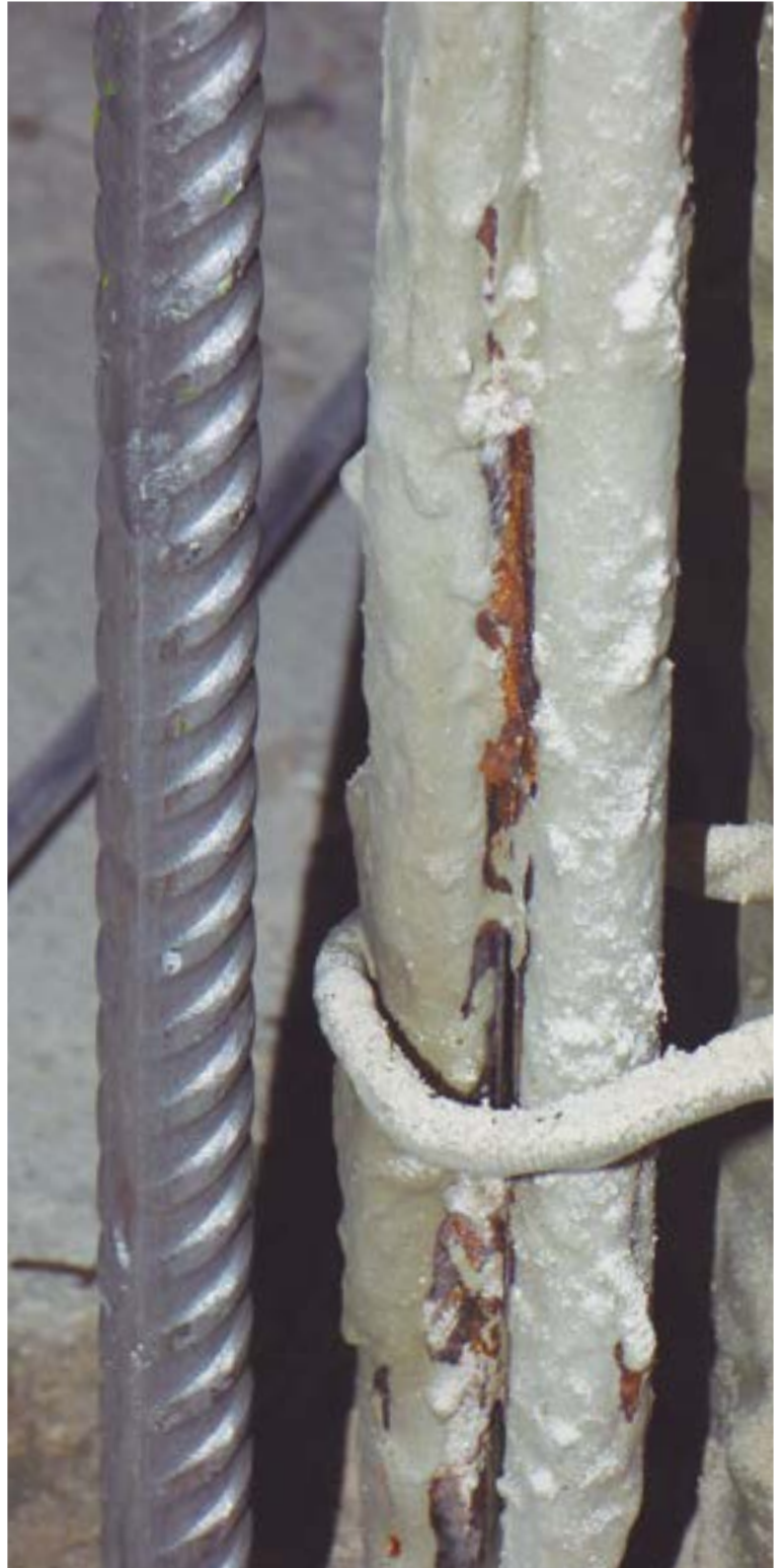
Fig 36. Armadura de corrugado inoxidable frente a armadura supuestamente saneada
