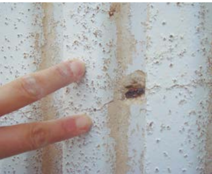
Fig 45. Fisura en aplacado prefabricado con constatación de armadura corroída
