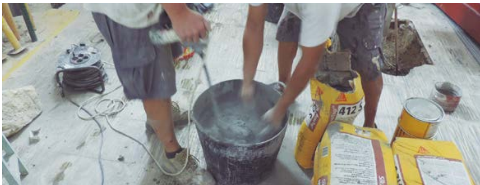
Fig 157. Dosificación no controlada, se echa el mortero con las manos sin control preciso de la cantidad.
