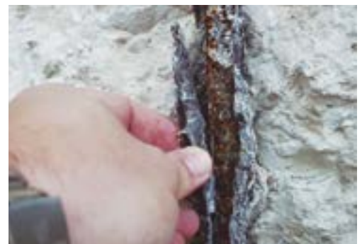
Fig 29. Detalle de armadura afectada por corrosión severa
