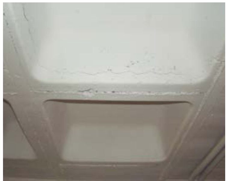
Fig 46. Fisuración en nervios de forjado reticular
