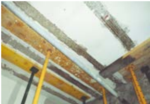
Fig 83. Viguetas de forjado con cemento aluminoso
