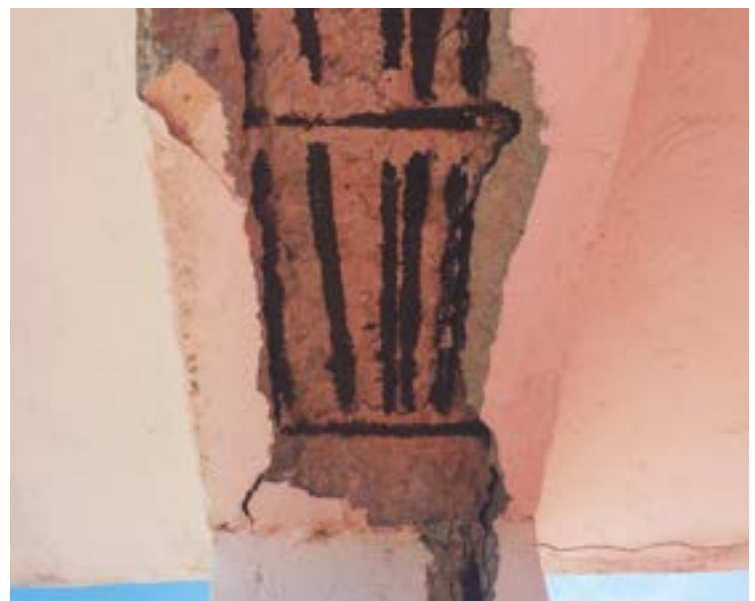
Fig 53. Desprendimiento en cara inferior de viga de canto
