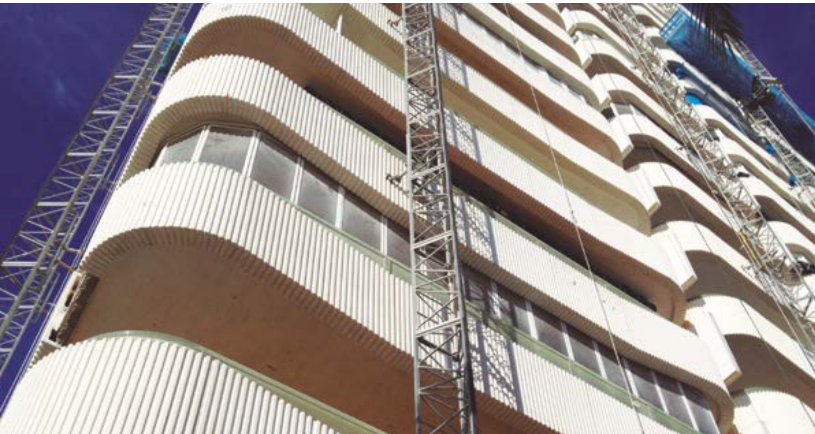
Fig 22. Detalle de aplacados de hormigón prefabricado afectado por corrosión
