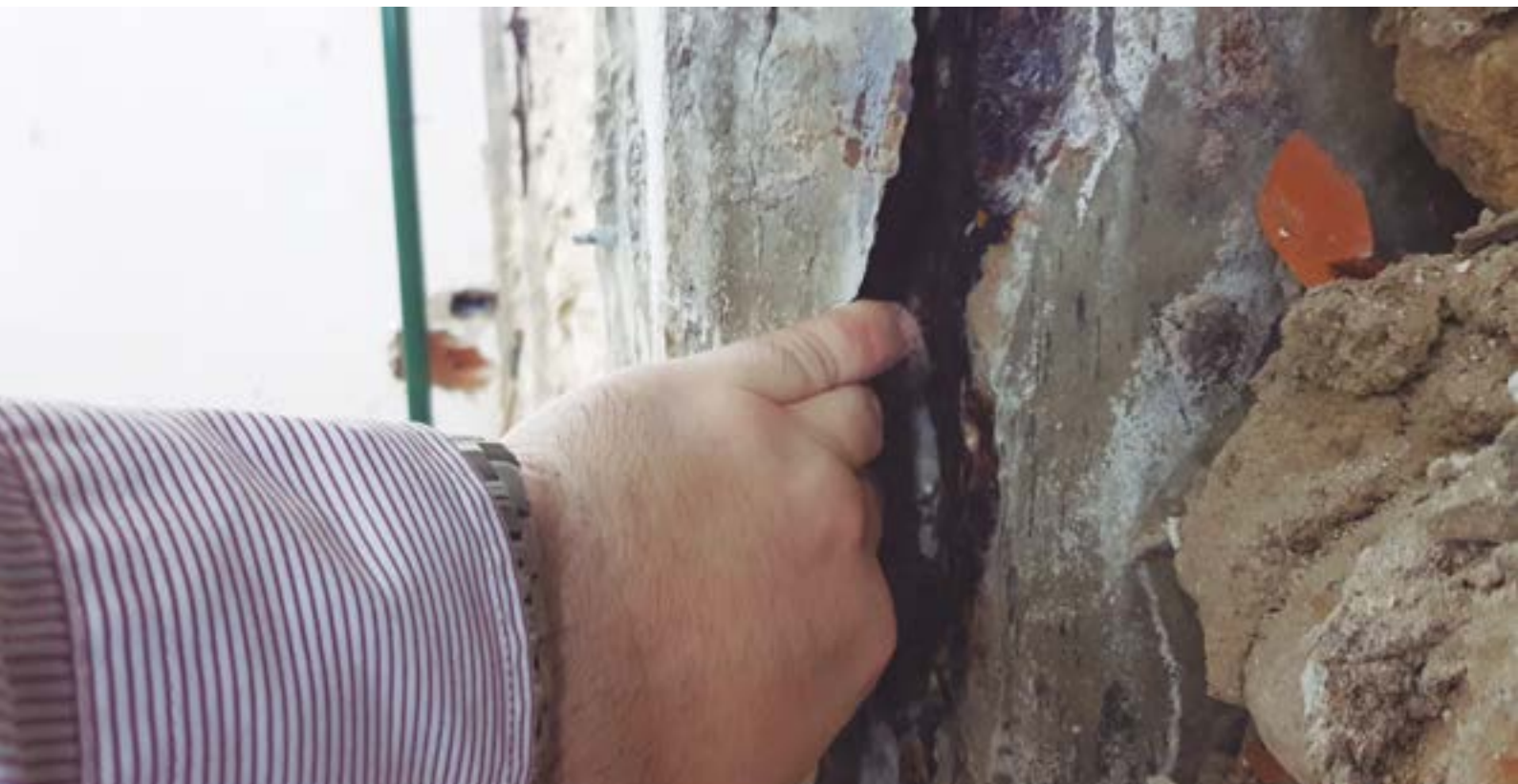
Fig 27. Detalle de pilar afectado por corrosión severa en planta sótano
