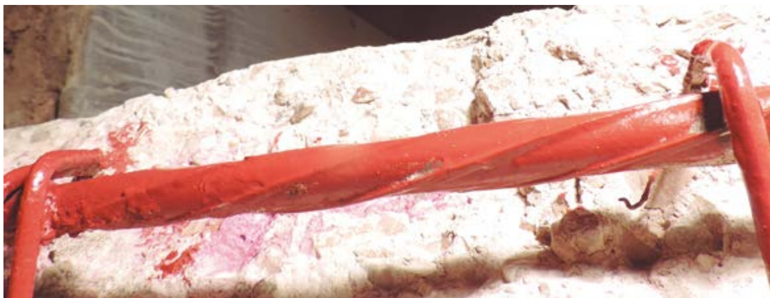
Fig 154. Capa incompleta de pasivador en encuentro entre barras y zona de corruga.
