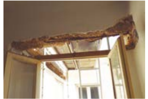
Fig 12. Daño estructural sobre carpintería
