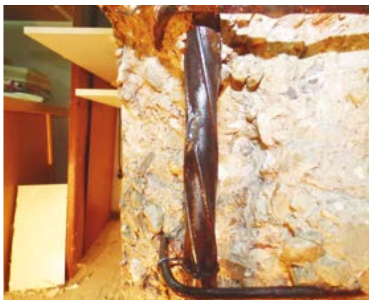
Fig 147. Restos de corrosión en la zona de las corrugas por una limpieza insuficiente
