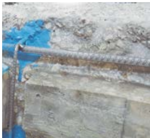
Fig 127. Proceso de colocación de puente de unión entre hormigón existente y mortero de reparación
