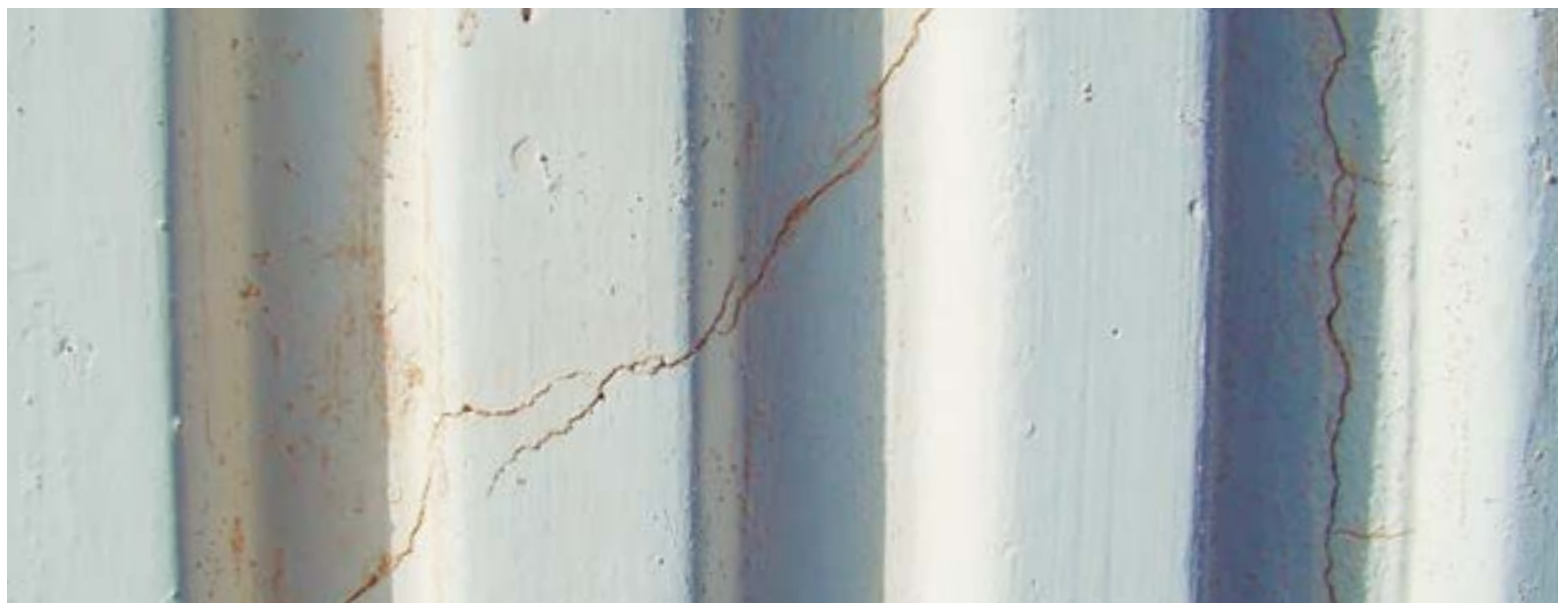
Fig 47. Fisuración en aplacado de hormigón prefabricado
