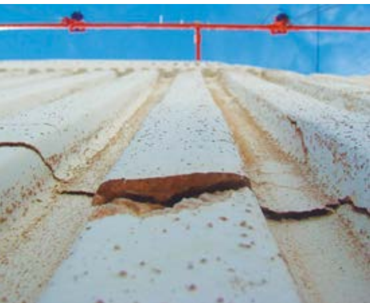
Fig 48. Rotura en aplacado de hormigón prefabricado
