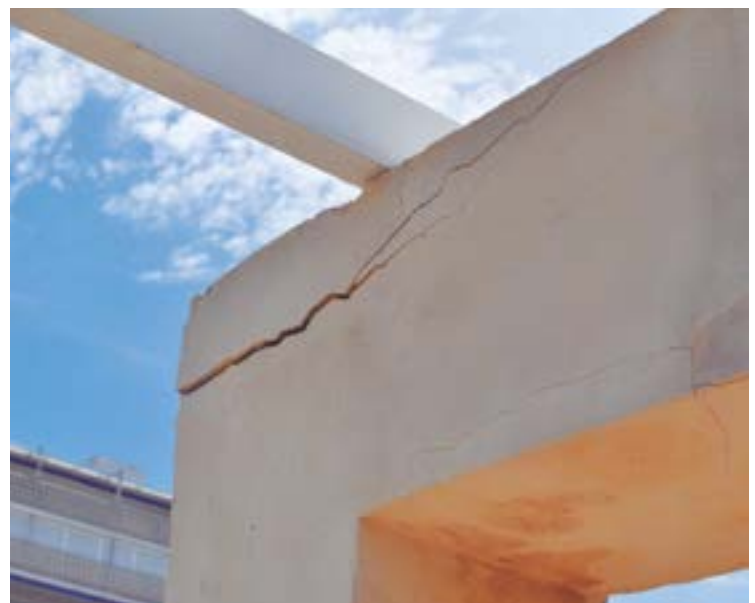
Fig 49. Grieta en pilar exento de última planta
