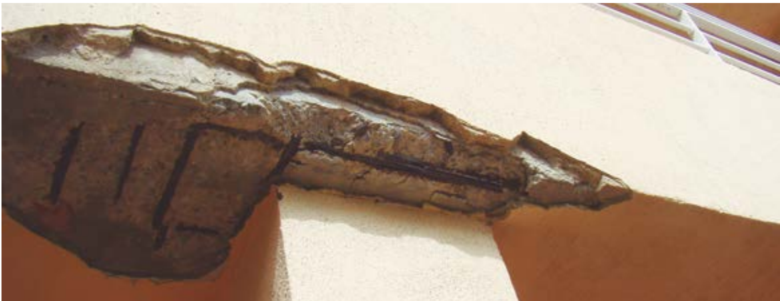
Fig 55. Detalle de desprendimiento en zona inferior de forjado y observación de armadura oxidadas
