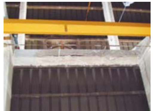
Fig 50. Grietas en cara inferior de viga de canto
