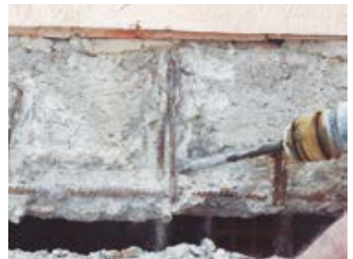
Fig 24. Picado de frente de forjado
