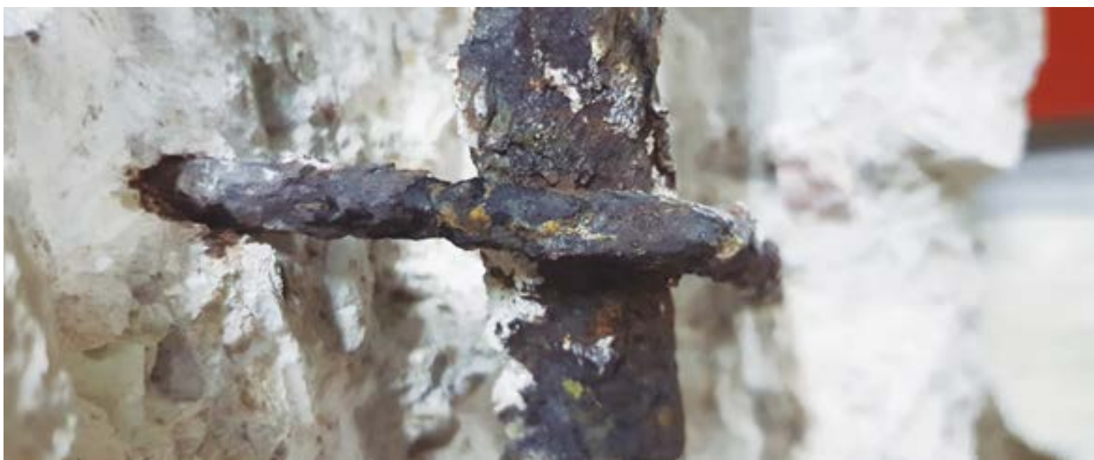
Fig 62. Detalle de corrosión puntual en pilar exento
