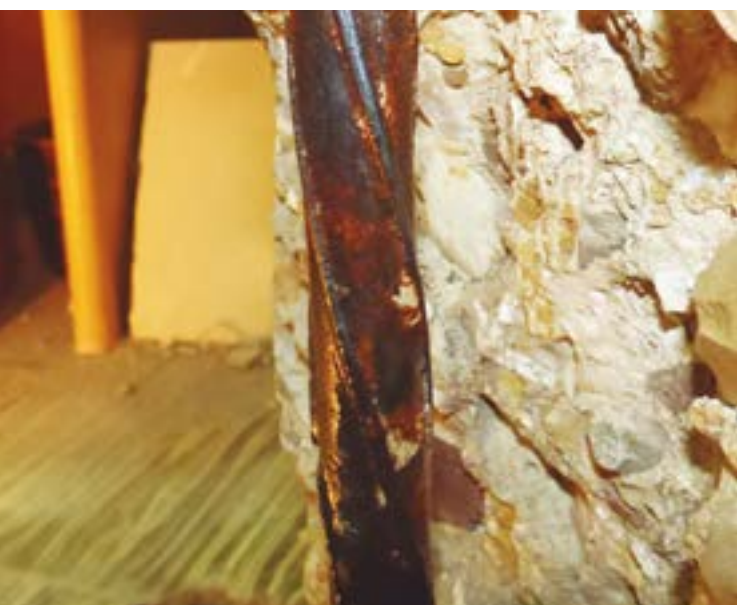
Fig 145. Restos de hormigón tras la limpieza
