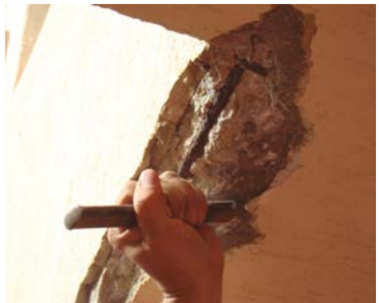
Fig 67. Retirada de revestimiento para observar estado de la armadura
