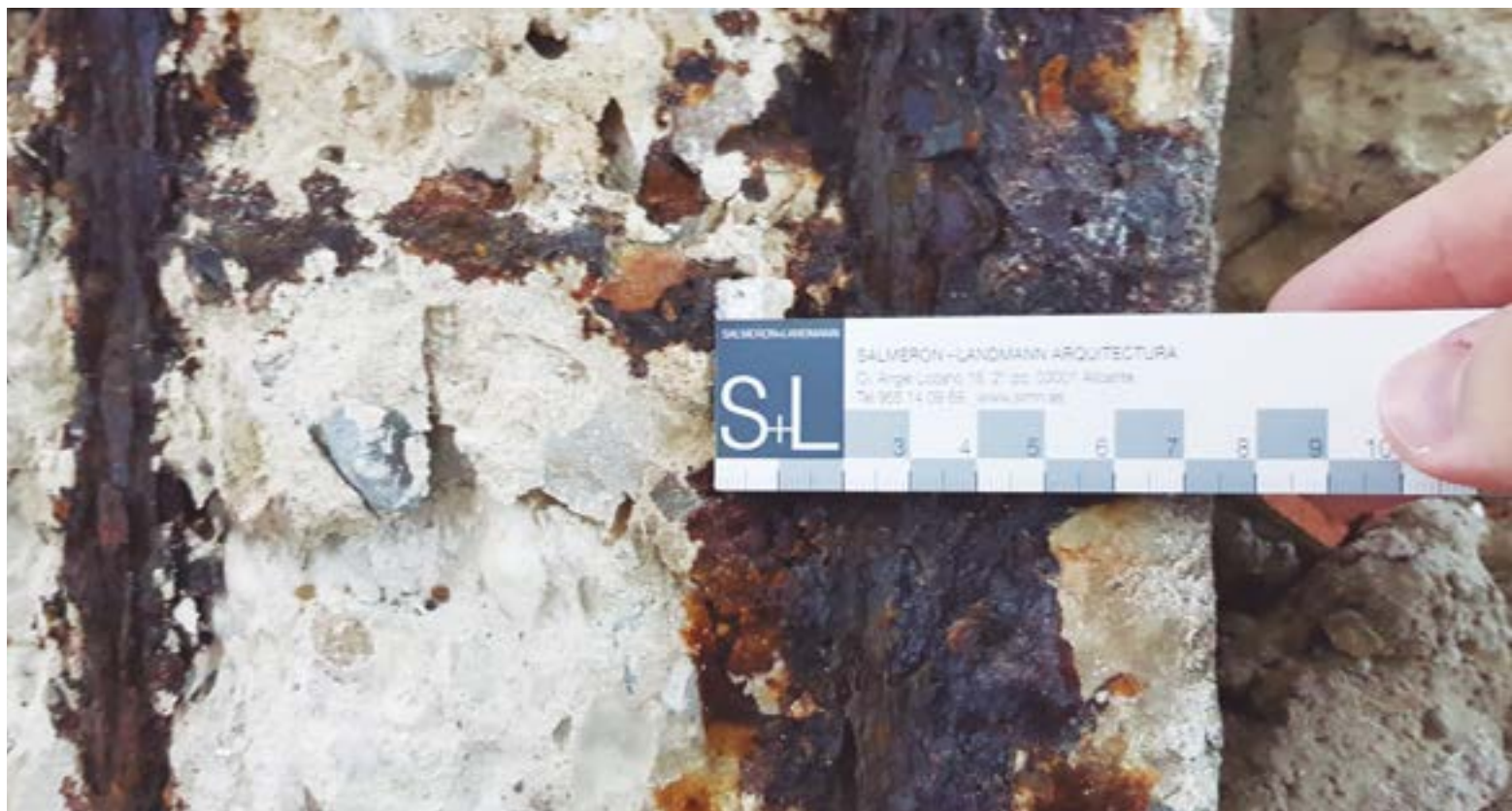
Fig 60. Detalle de migración de los productos de oxidación de una barra corrugada
