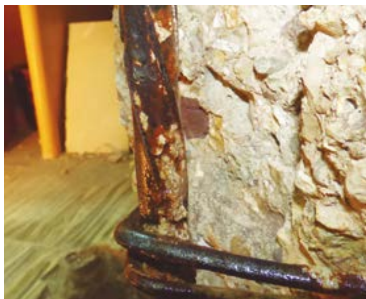
Fig 146. Hormigón contaminado por limpieza insuficiente
