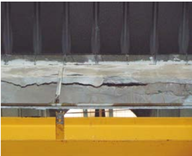
Fig 17. Detalle de zona afectada sobre puente grúa
