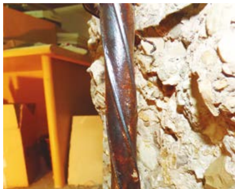
Fig 148. Contraste de zonas limpias con restos de corrosión
