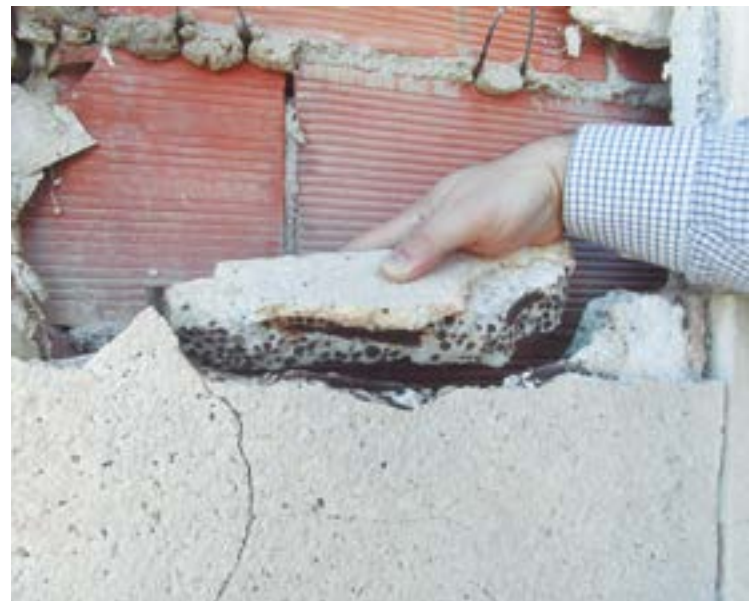
Fig 69. Visualización del estado de la armadura del aplacado
