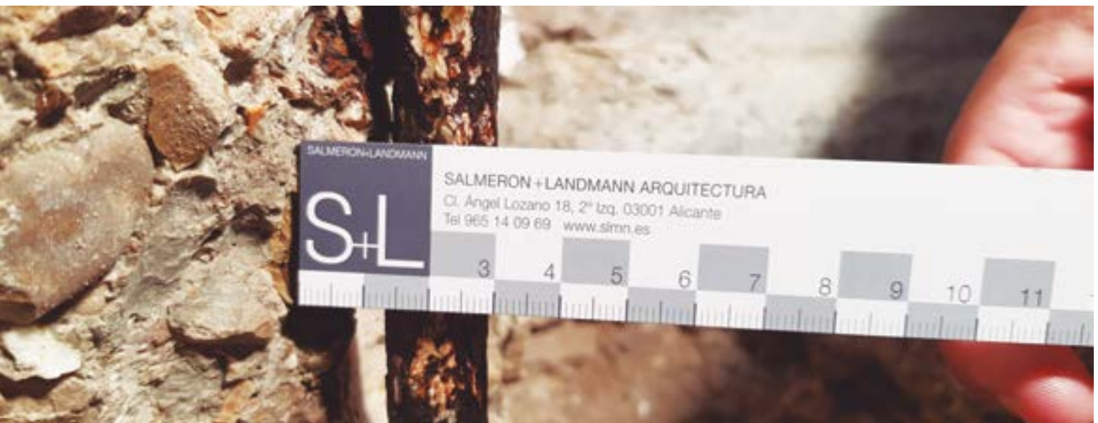
Fig 141. Picado insuficiente detrás de la barra
