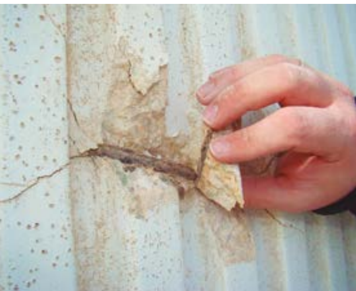
Fig 52. Desprendimiento en aplacado de hormigón prefabricado
