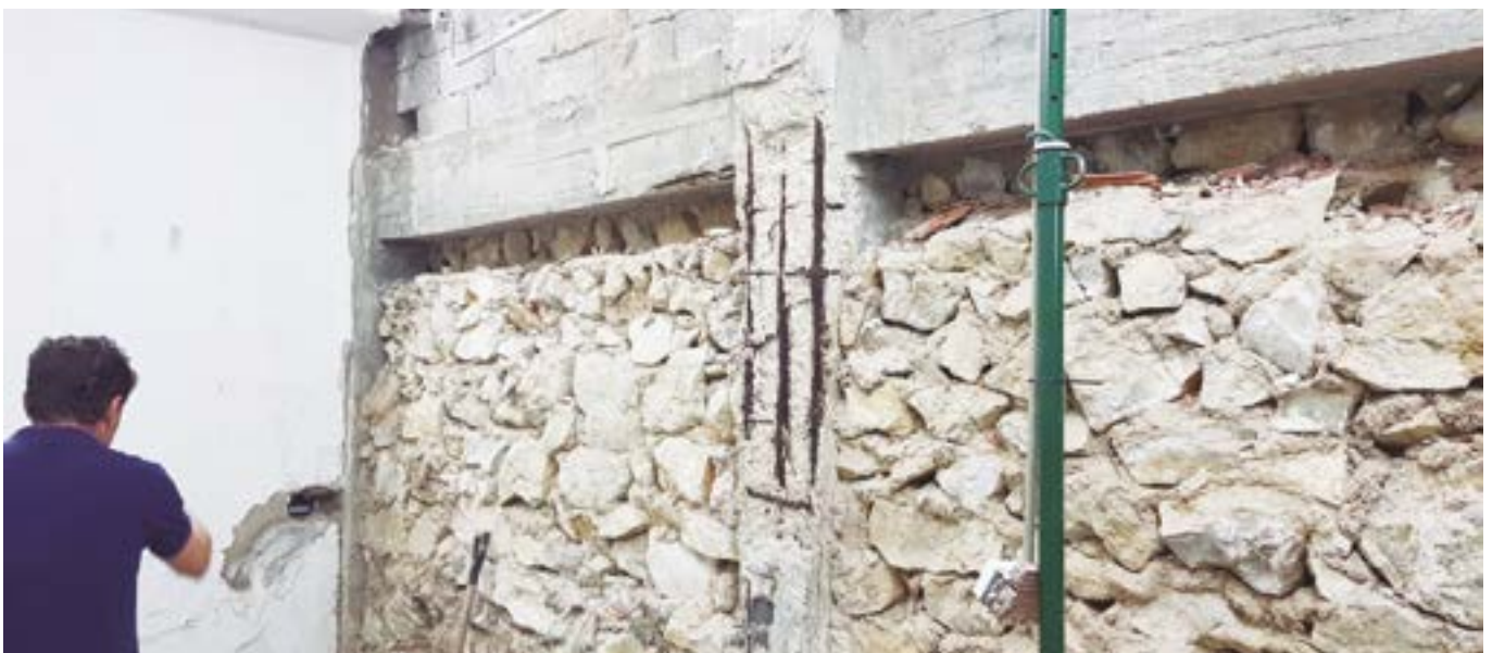
Fig 28. Vista general de pilar afectado
