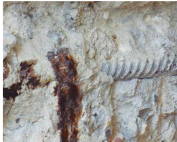
Fig 11. Corrosión no homogénea
