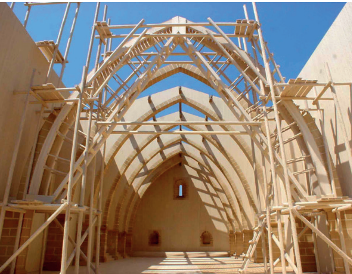
Maqueta de la iglesia parroquial de Olocau del Rey (Castellón) en construcción conforme al proyecto de 1298.
